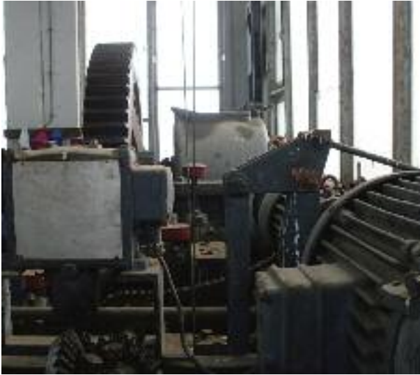
Mechanizm podnoszący zamknięcia jazu na Stopniu Brzeg Dolny
