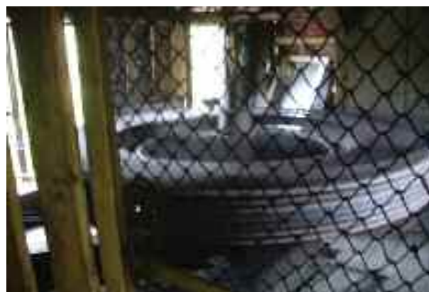
Turbina elektrowni wodnej w Kamienniku
