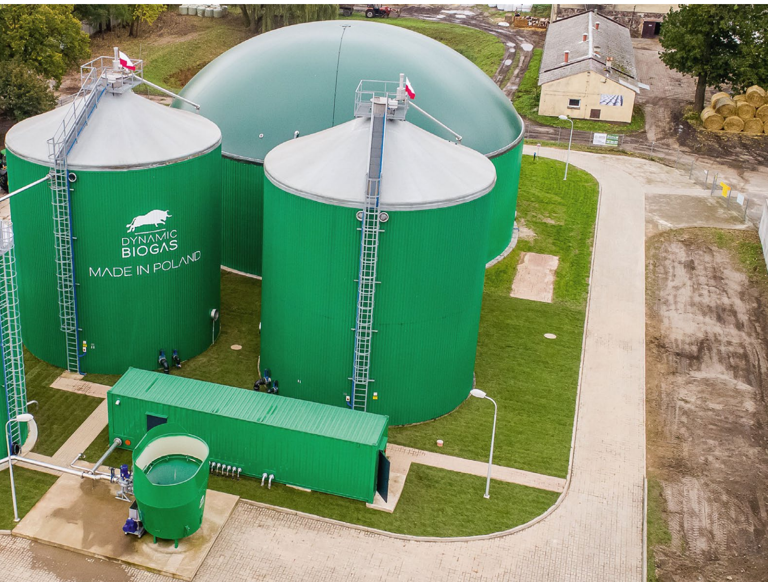
Biogazownia w Zakładzie Doświadczalnym Uniwersytetu Przyrodniczego w Poznaniu w Przybrodzie
